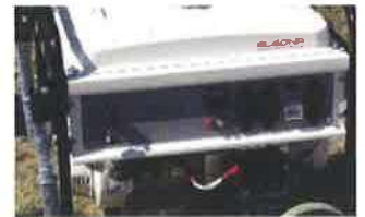
プロパンガス使用発電機
